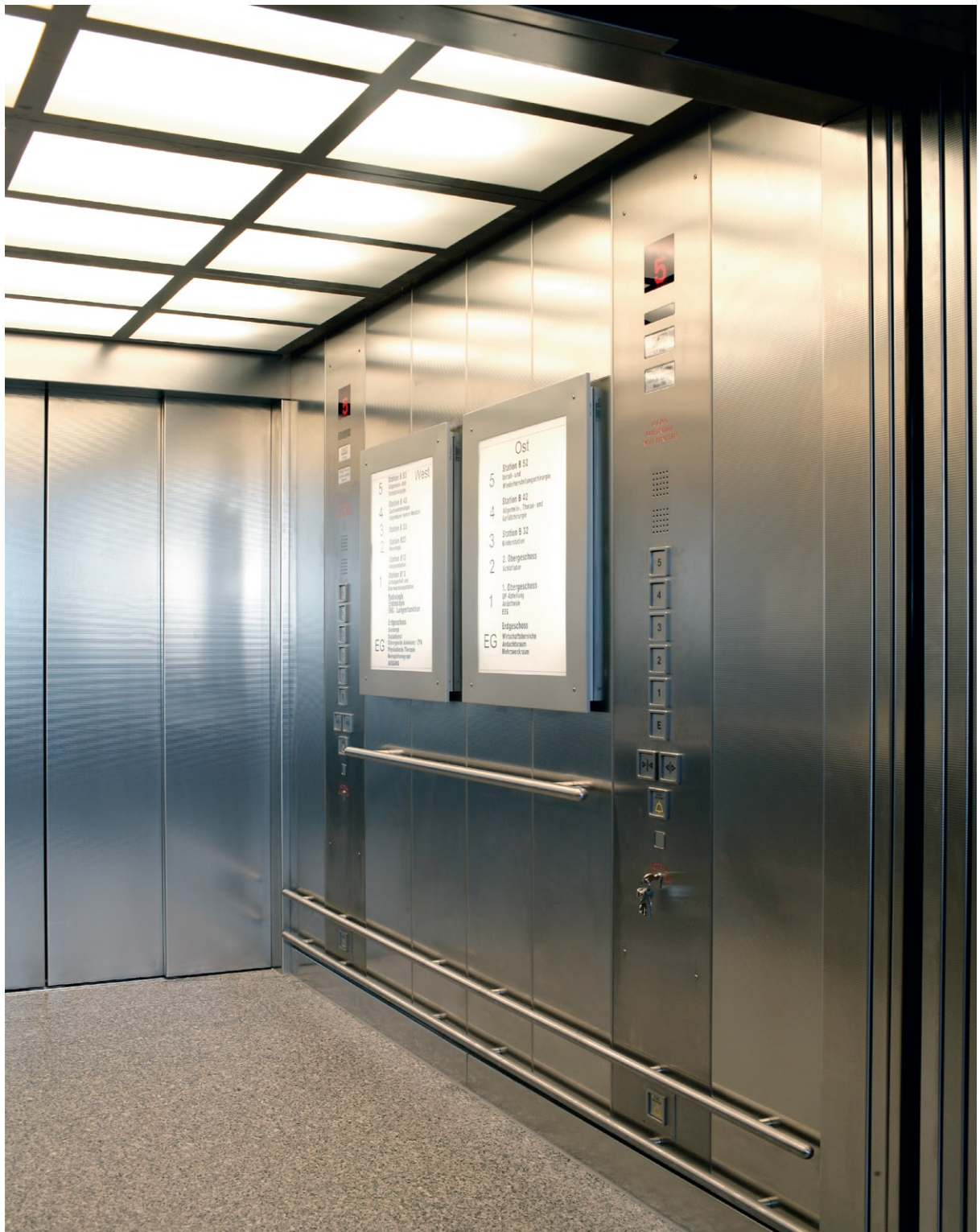
Bettenaufzug, Durchladung Wände: V2A, 3-facher Rammschutz, Decke Edelstahl mit integrierten Leuchtstoffröhren
