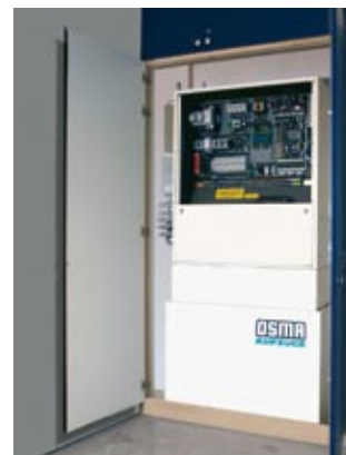
Kompaktaggregat am Schacht
