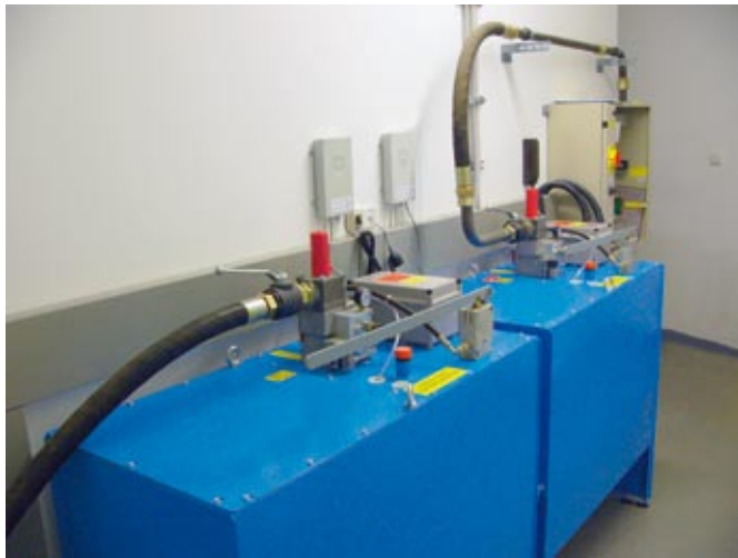
2 Hydraulikaggregate im Maschinenraum (2er-Gruppe)
