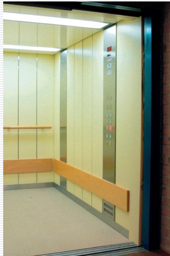
Aufzugskabine, KSB-Oberfläche, PVC-Boden, Rammschutz, Handlauf
