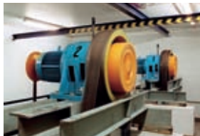
neue Seilantriebe (2 Aufzüge)
